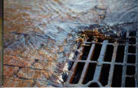
ภาพ 2 น้ำสกปรกไหลลงสู่ระบบท่อระบายน้ำ
