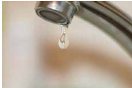
ภาพ 1 หยดน้ำออกมาจากก๊อกน้ำที่เปิดไม่แน่น
